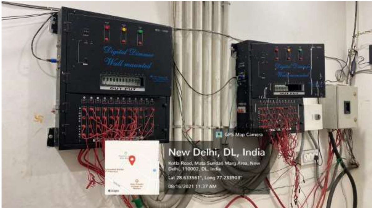
Digital Dimmer (Auditorium)
